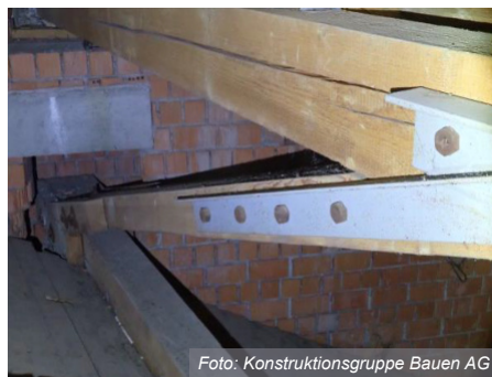
Balken mit starker Rissbildung
